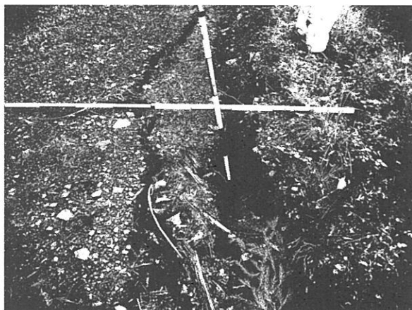
図-1 発生したクラックの例 Fig.1 an example of occurred crack
