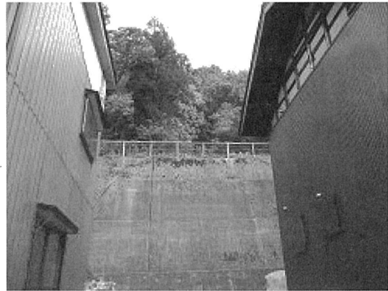
写真-1. レッドゾーン内にある家屋の一例
